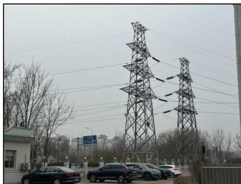
前进站南侧架空出线
