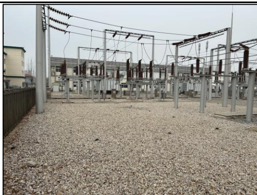
110kV 配电装置区
